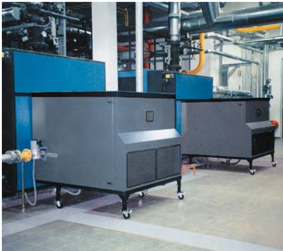
W-SH 20 в котельной: ввод топливных линий и электрических проводов планируется каждый раз индивидуально
