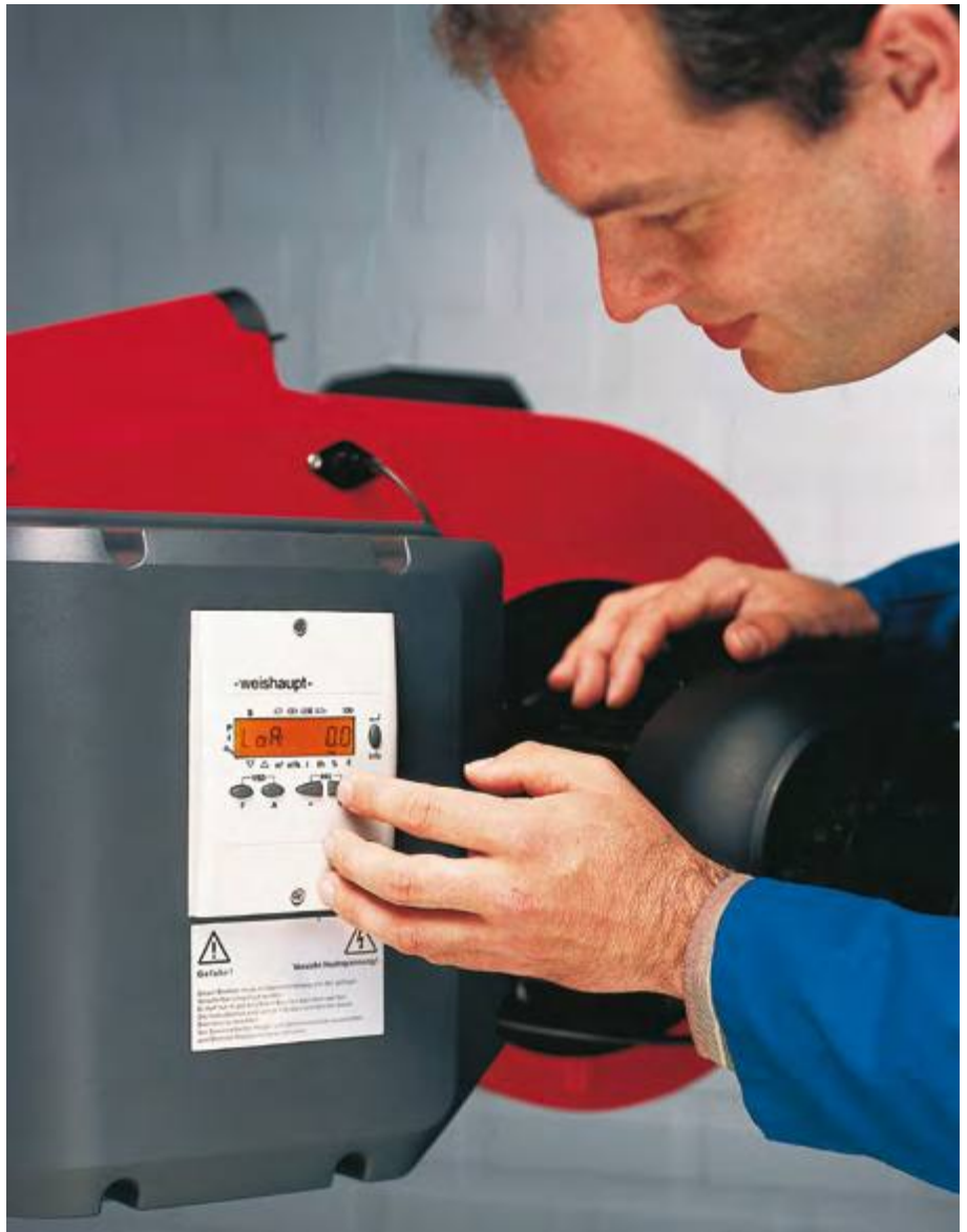
Ввод и контроль данных при помощи блока управления и индикации (W-FM 50/54)
